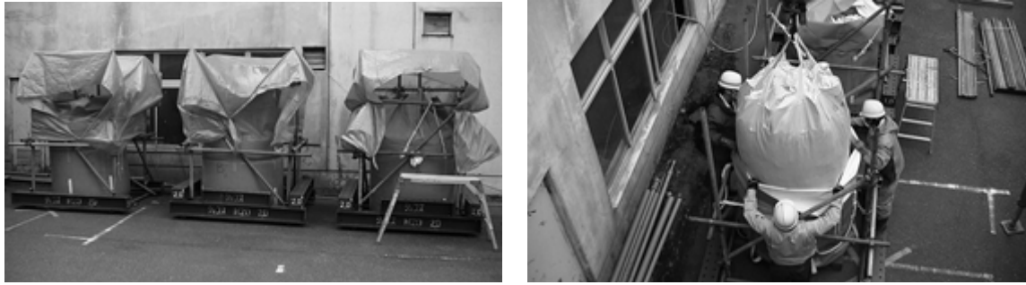
写真2：飛灰フレキシブルコンテナの設置状況
